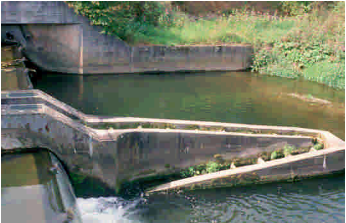
Abb. 4.42: Das Wehr in Niederhone bildet ein unüberwindliches Hindernis für in der Wehre aufsteigende Fische; die Fischaufstiegsanlage weist so gravierende Konstruktionsmängel auf, daß sie als vollkommen funktionsunfähig einzustufen ist
