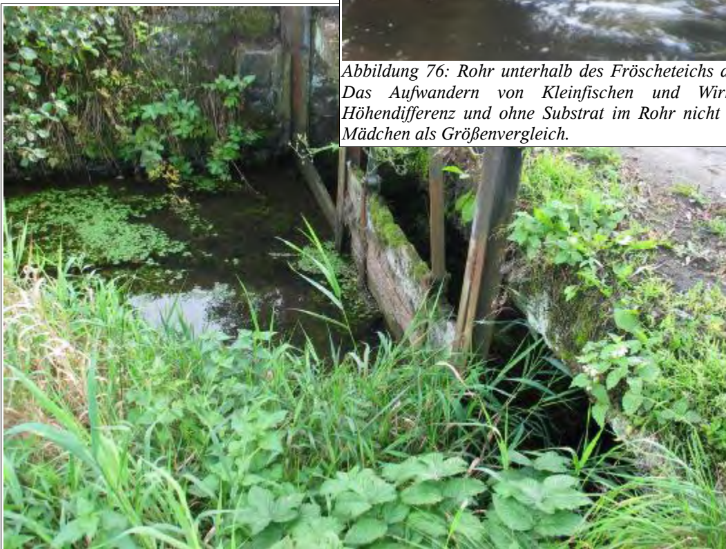
Abbildung 77: Ausleitung der Mühle in Bracht. Der Abfluss in das ursprüngliche Gewässerbett ist nahezu vollständig unterbunden und am Wehr ein Absturz von etwa 30 cm vorhanden. Dies ist für wandernde Fische unpassierbar.
