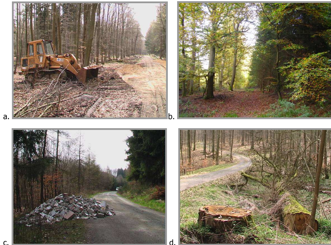
Abb. 12: Beeinträchtigungen und Störungen im FFH-Gebiet „Wald östlich von Allendorf und nördlich von Leun. Wegebaumaßnahmen im FFH-Gebiet „Waldgebiet östlich von Allendorf und nördlich von Leun“ südlich des Himmelsbergs (a.), Douglasienfläche am Südhang der Bieler Burg (b.) Bauschuttalagerungen (c.) und Alteichenfällung wegen Verkehrswegesicherung (d.) (Fotos: Markus Dietz).
