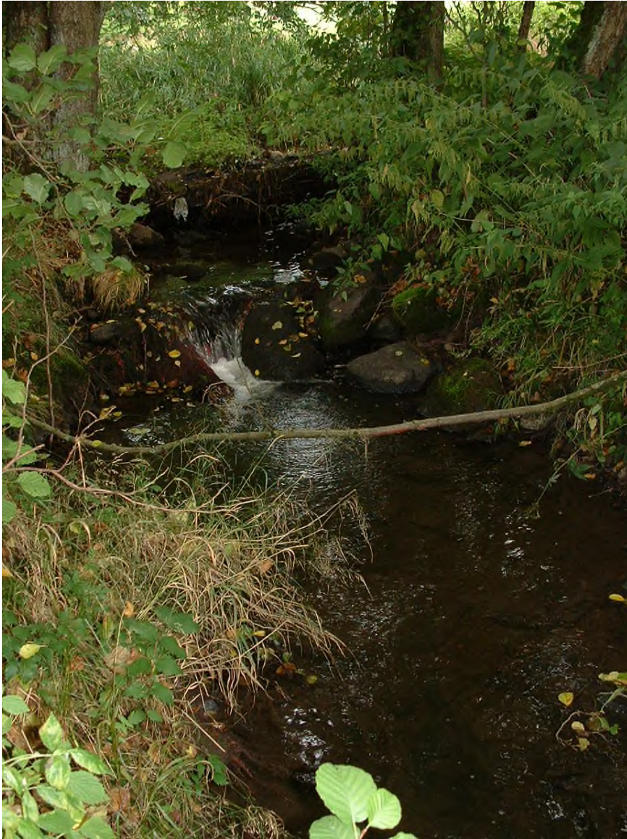
Abb. 8.2.1.1.7: Massivsohle mit Absturz im Bereich des Regenüberlaufbauwerks der Kläranlage Holzmühl.
