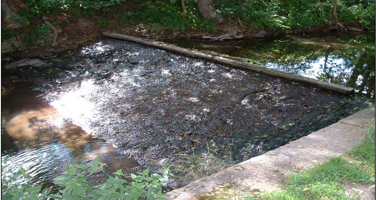
Abb. 8.2.1.1.1: Querbauwerk nordwestlich von Köppern ist aufgrund der Höhe als vollständig unpassierbar einzustufen. Als Sanierungsmaßnahme wird eine Anrampung empfohlen.
