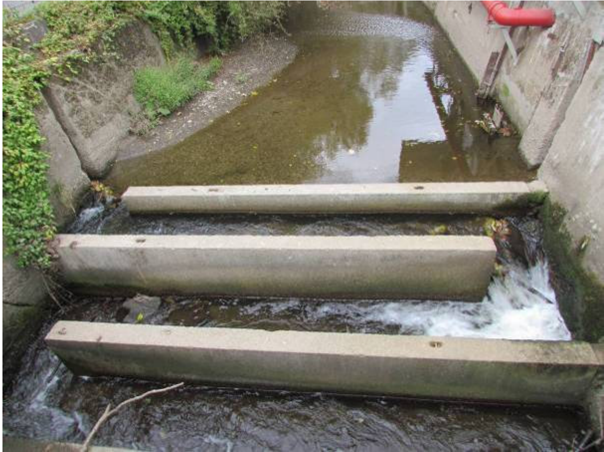
Abbildung 23: Fischpass am Wehr auf dem Firmengelände der Fa. Schlaadt
