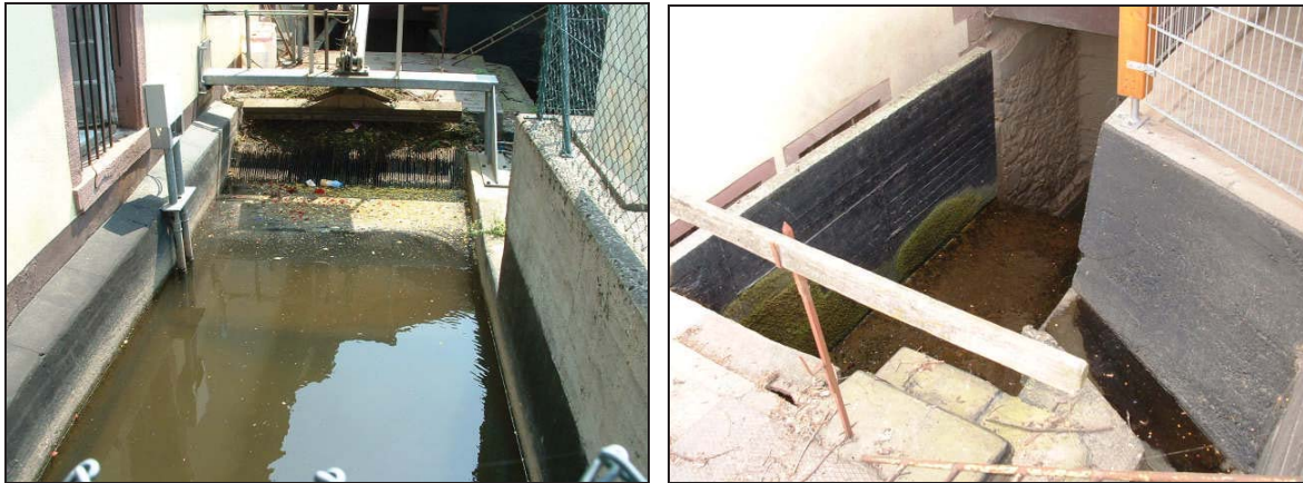
Abb. 8.2.1.1.1: Bereich Herrnmühle in Reichelsheim. Unpassierbar durch Verrohrung und Absturz.
