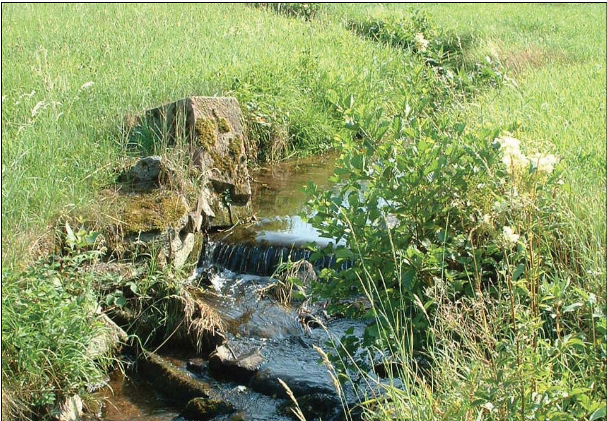
Abb. 8.2.1.1.3: Bereich Steinkopf an der K 52. Aus heutiger Sicht besteht keine Notwendigkeit zum Erhalt des kleinen Absturzes. Das Entfernen scheint bei geringem Kostenaufwand unproblematisch.
