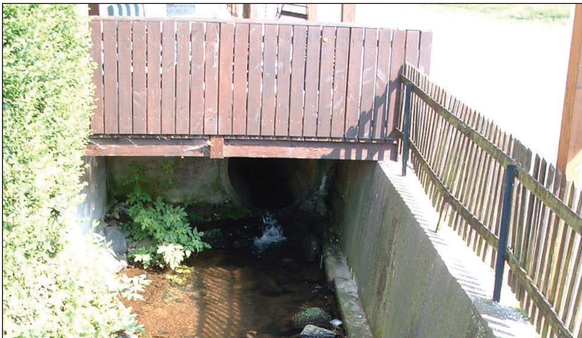
Abb. 8.2.1.1.2: Die Verrohrung unterhalb eines Gebäudes lässt der Wiederherstellung der Durchwanderbarkeit keinen Spielraum
