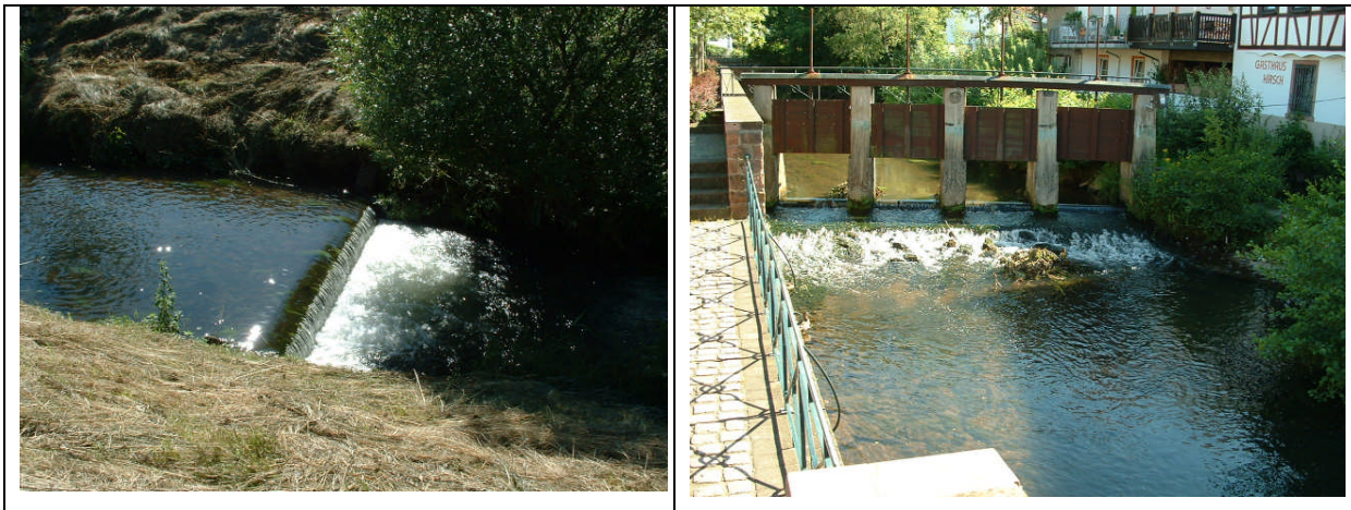
Abb. 8.2.1.1.4: Der linke Typus ist in Erbach 15-fach vertreten. Durch Anrampung ist die lineare Passierbarkeit herstellbar. Hingegen sind größere Baumaßnahmen im Bereich Zentrum Erbach nötig, um die Durchwanderbarkeit zu gewährleisten (Bild rechts).
