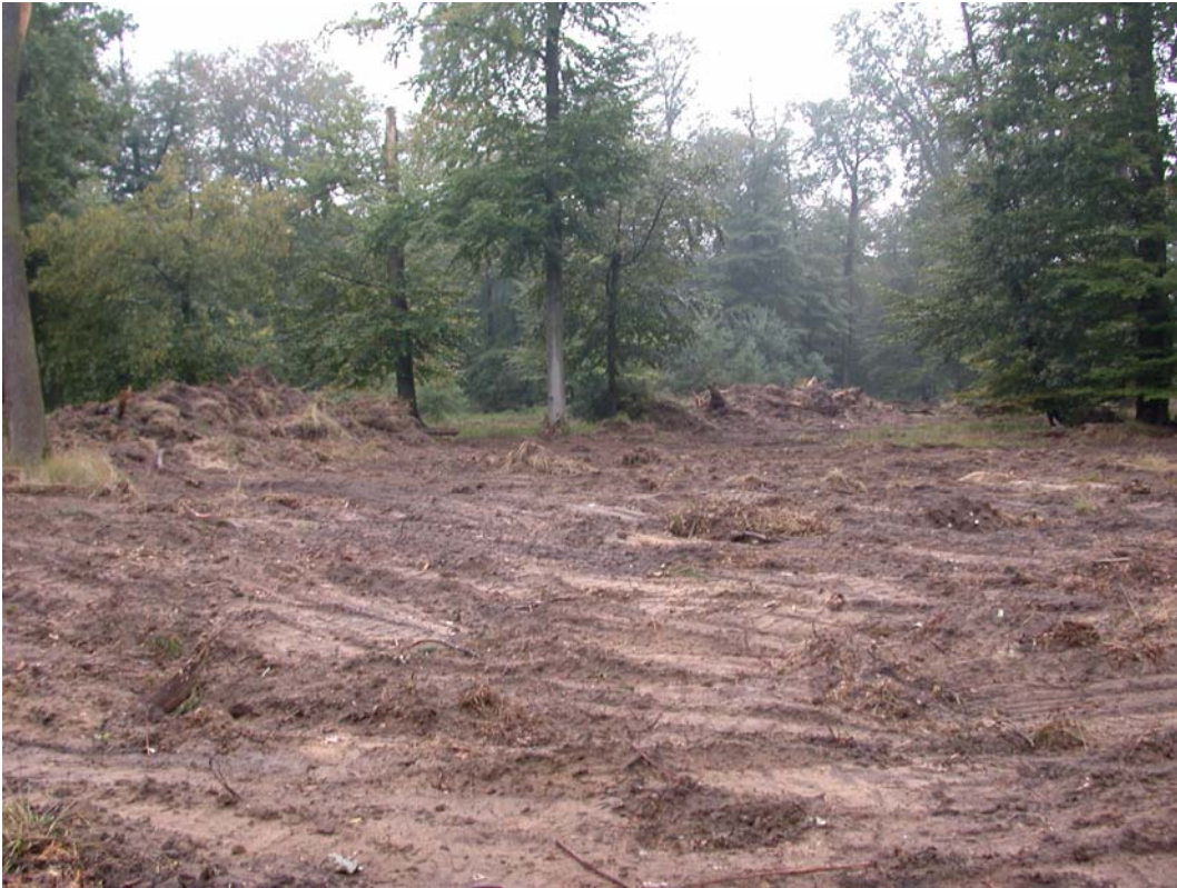
16: Reliktwald Lampertheim, Ostteil; Stubbenrodung und Abschieben der Vegetationsschicht als Vorbereitung zur Wiederbewaldung durch Naturverjüngung; Aufnahmedatum: 01. Oktober 2004
