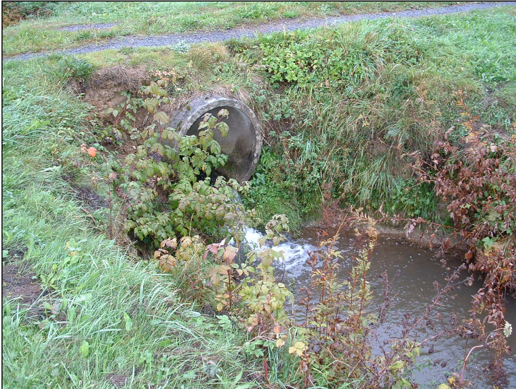
Abbildung 8.2.1.1.1: Insbesondere für Schwachschwimmer wie die Groppe unpassierbar - der Typus „Verrohrung mit Absturz“ kommt im nördlichen Bereich der Urff mehrfach vor.
