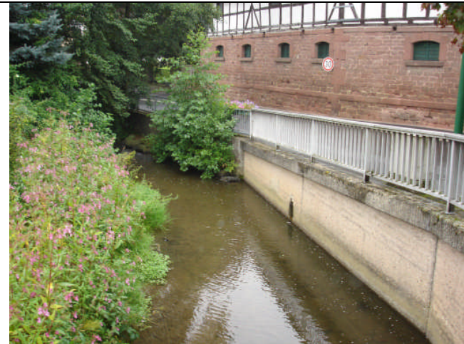
Naturfremder Uferverbau in Oberurff
