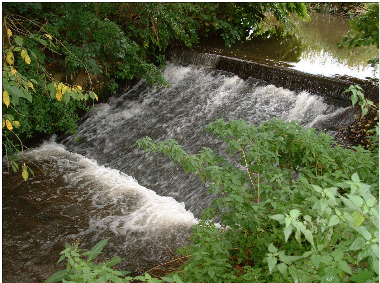
Abbildung 8.2.1.1.10: Das Streichwehr QWB_25 liegt zwischen Niederurff und Einmündung der Urff in die Schwalm. Die Funktion „Bewässerung der landwirtschaftlich genutzten Fläche“ schafft zwei Probleme: Durchgängigkeit und ökomorphologische Veränderung im Rückstaubereich.
