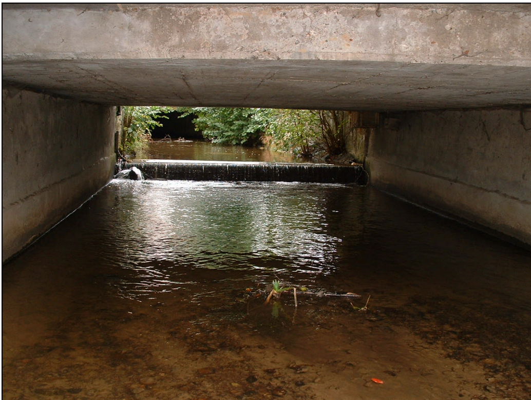
Abbildung 8.2.1.2.1: Niederurff - auch „kleinere Abstürze“ führen zu Sedimentationsprozessen feinkörniger Substrate; die Substratvariabilität und demzufolge die Besiedlungsfähigkeit für Fische ist hier eingeschränkt.
