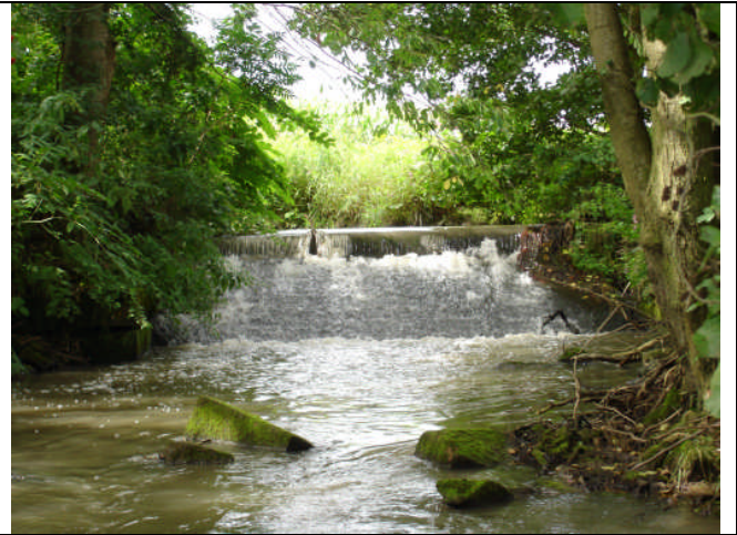
Unpassierbares Wanderungshindernis (QBW_25) kurz vor dem Mündungsbereich der Urff in die Schwalm
