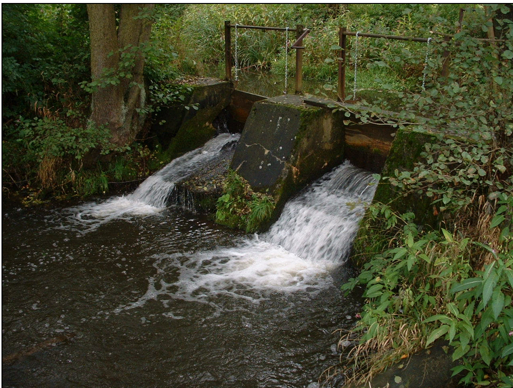
Abbildung 8.2.1.1.2: Das Schiebewehr (QWB_10) bei Bergfreiheit dient der Speisung einer Teichanlage. Zur Wiederherstellung der Passierbarkeit sind größere (Um-)Baumaßnahmen notwendig.
